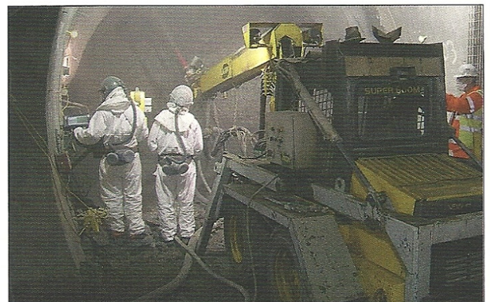
Obr. 8 Aplikace stříkaného betonu systémem TunnelBeamer Fig. 8 Spraying concrete using the TunnelBeamer system
