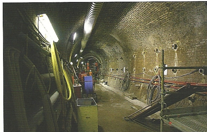
Obr. 15 Vrtvy pro kompenzační injektáž ve starém tunelu Maiden Fig. 15 Compensation grouting boreholes in the old Maiden Lane tunnel
