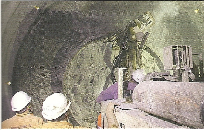
Obr. 7 Ražba spojovacího tunelu mezi přístupem k trase Piccadilly a přístupem k trase Victoria, procházející starým spojovacím tunelem z trasy Thameslink, vyplněného pěnobetonem
